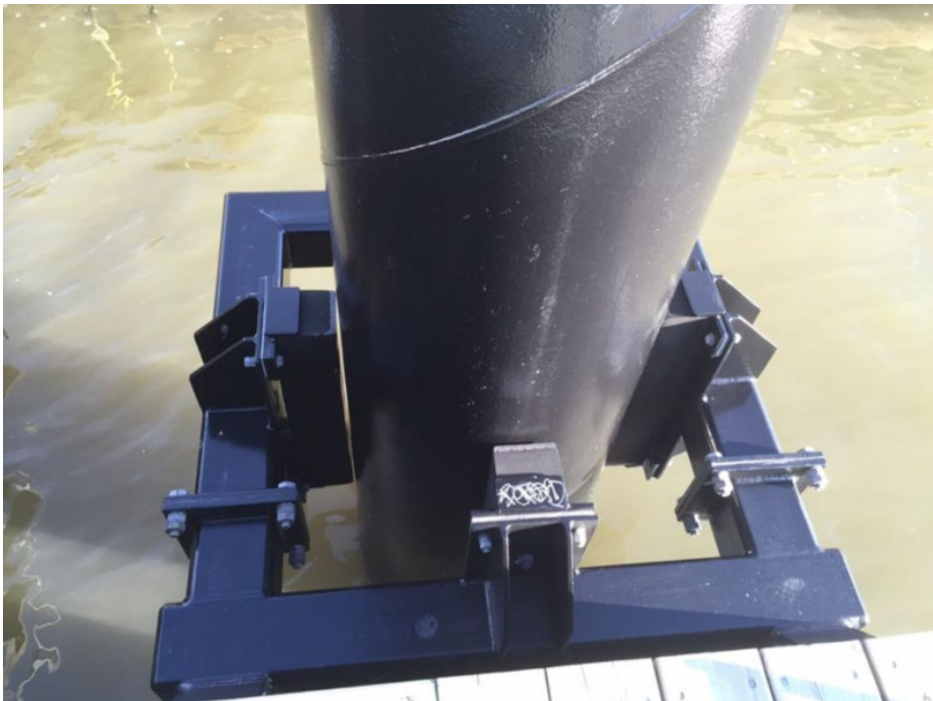
Figur 2. Exempel på påle och pålkrage. Foto: Göteborgs Stad
